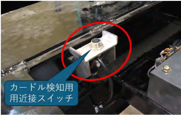
図 3-3 カードル検知スイッチ
