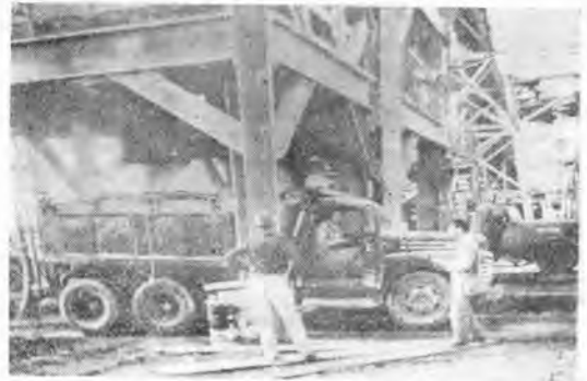
写真-1 バッチングプラント
