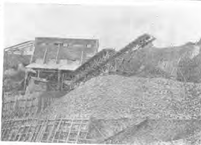
クラッシングプラント前サージパイル
