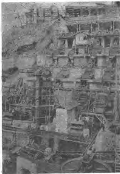
丸山ダム骨材破碎篩分装置
