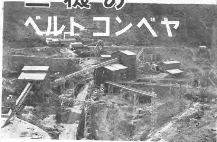
九州電力株式会社・上椎葉建設所殿 クラッシングプラントコンベヤ設備
