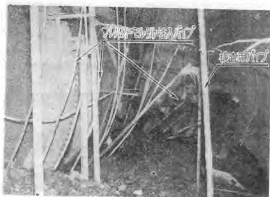
写真-2 熊本県藤本発電所ケーシング工場の様子、 プレバクト・コンクリート施工粗骨材投入及び 配筋
