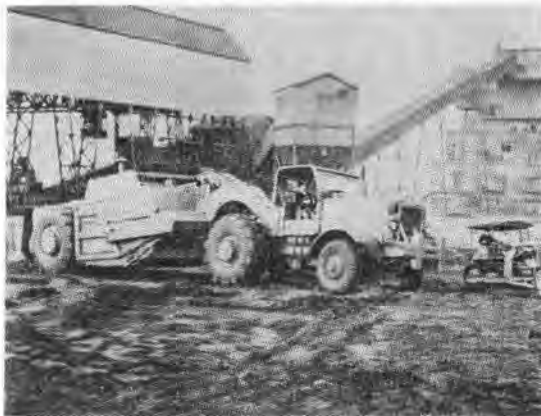
Fig. 1 屋外貯炭場のスクレーパ・トラクタ 右側後方は微粉炭製造室其の前方にアングル・ブドーザがある。
