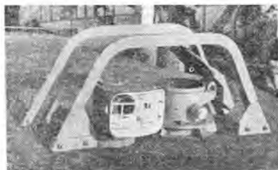
写真-1 空気抜孔および開閉標示灯 (開の青)
