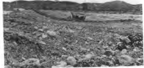
写真-2 京都府綾部市若松に应急復旧工事中のブルドーザ
