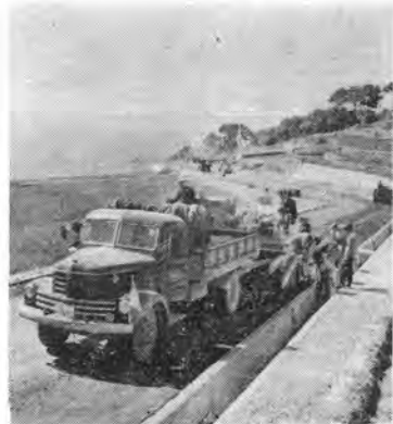
写真-19 フィニッシャによる舗設作業 (トールゲート付近) 労務者 10~13 人を配し 4,000 m 2 /日施工した。
