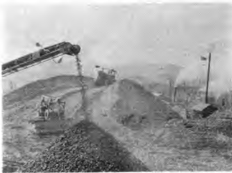
写真-7 愛野プラントの状況 煙突はアスファルトプラントの活動を示す
