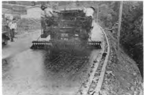
写真-20 デイストリビュータによるアス撤布 (シールコート工) スタンダードスチール社製のデイストリビュータはドラッグブ ルームを付して労務者 13 人程度で 20,000 m 2 のシールコー トが可能であった。
