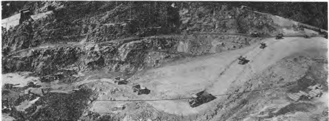
写真—1 ダム掘削ダンプ昇降路の傾斜状況 (これよりちよつと以前の最盛期はこの写真よりも傾斜が強い)
