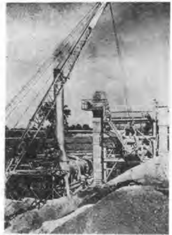
写真-1 Koehring-Waterous 社のアスファルト・プラント
