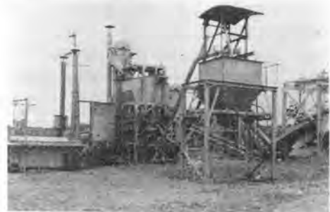
写真-2 ポータブルアスファルトプラント
