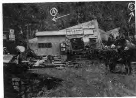
① 矢の方向約 480 m で本ずい道に達する ② ベルコンでずい道裏の谷間にずりをすてる 写真-6 斜坑坑口
