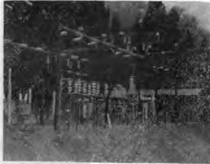
写真-1 孫谷変電所全景
