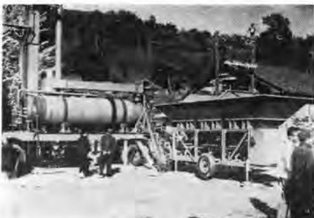
写真-2 骨材供給ホッパおよびドライヤ部分
