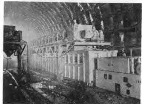
写真-5 坑内のデクソン型三機製コンベヤ
