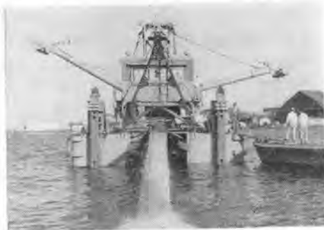
写真-3 改造前のノズル
