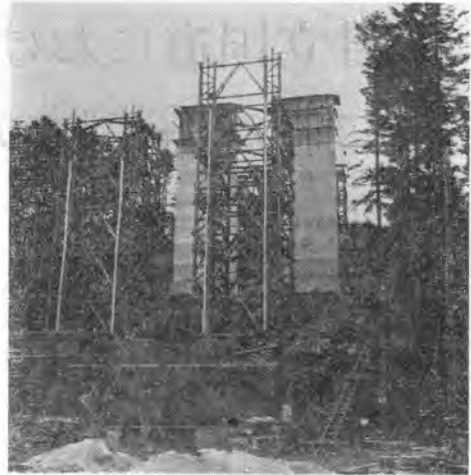
写真—74 オーストリア——ウィーンの森を貫くオートバンの橋りょう工事現場
