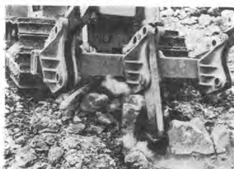
写真-5 粘土質砂岩の破碎状況
