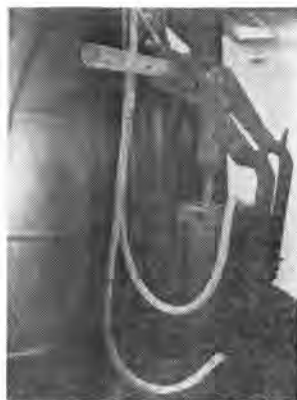
写真-4 ミキサ吐出シュートに水銀スイッチを装備した状況
