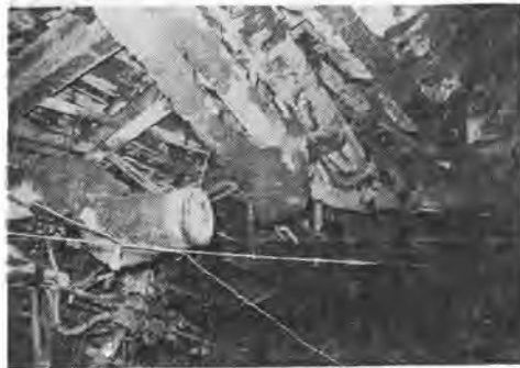
写真-6 地下埋設物錯そう状況
