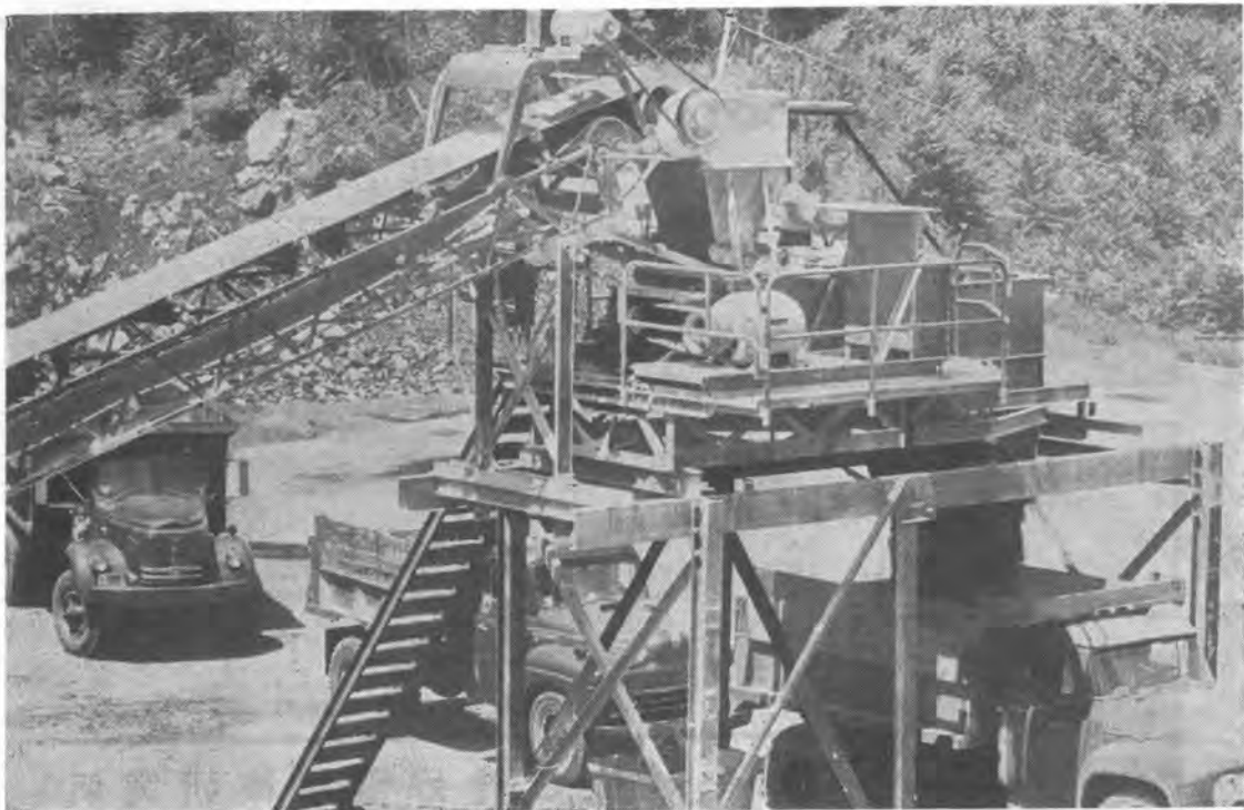
新型バーバー・グリーン安定混合用プラントの稼動状況
