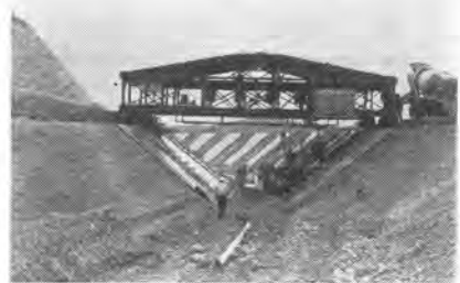
写真-4 幹線水路の城東開水路ライニング工事 ライニング部断面：底幅 3.2 m, 高さ 3.6 m, 側法 1:1.25 m,
