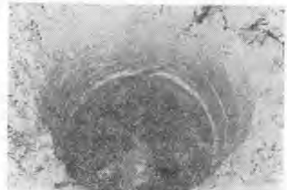
写真-7 ベントナイトを使用して砂れき層の孔壁を保護している状況
