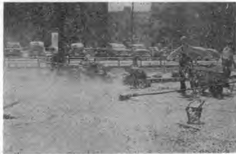
写真-2 写真中央でグースアスファルト合材を木こてで路面に敷均している。ネコ車の中のまぶし碎石 (5-8 mm) をスコップに取り均したグースアスファルト面に散布しようとしているところ。
