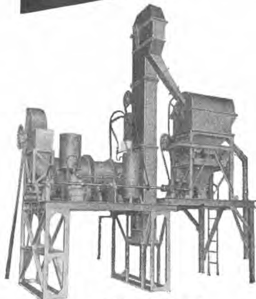
アスファルトプラント
