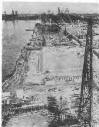
写真-3 豊洲鉄鋼埠頭建設工事 (砂くい打、載荷上げ、ウエルポイント)
