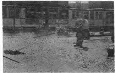
写真-3 2人の労務者がハンドローラを用い、碎石をグースアスファルトの舗装面に圧入、仕上げているところ。
