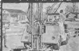
道路舗装面の破壊
