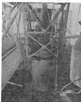
写真-3 ベーストヘッドタンク と計量槽
