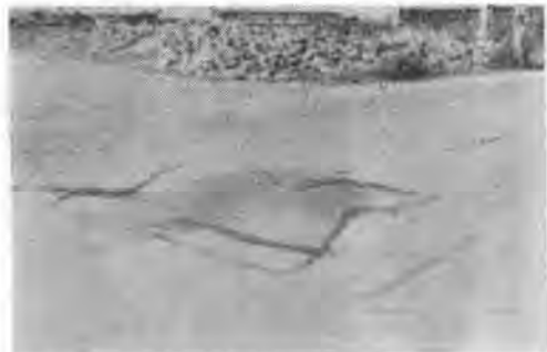
写真1 ポンピング作用によって泥土を噴出し、コンクリート舗装版の亀裂
