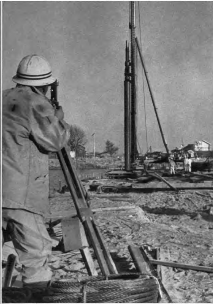
筏川基礎鋼管くい建込 (デルマックD-22形ディーゼルバイルハンマ)
