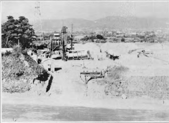
⑪ B.G.60t アスファルトプラント全景
