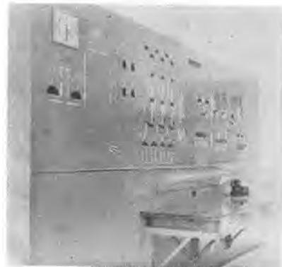
写真-3 総合管理室
