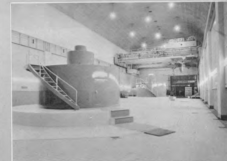
完成した発電機室—左1号機、右2号機および 270t天井クレーン2台
