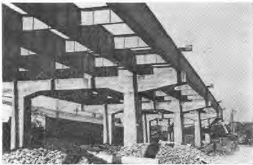
写真-2 首都高速道路1号線 都立芝商業高校脇高架部工事現場
