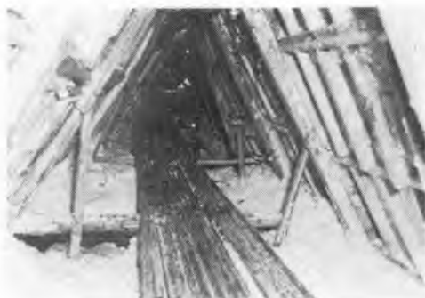
写真-6 冬期間の配管設備
