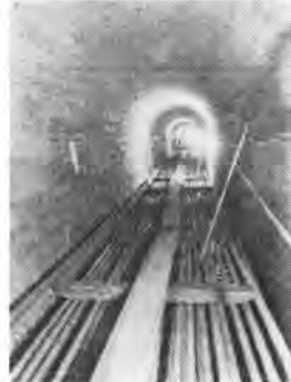
写真-12 通廊内の配管設備
