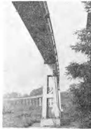
写真-3 軌道に取付けられた給電軌条
