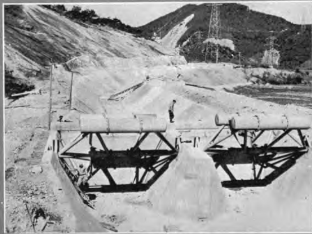
↑ 幹線水路工事：神尾開水路の神尾水位 調節せき (Noyrpio Type Automatic Control Gate)
