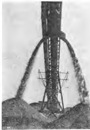
写真-5 ベルト最下端における土砂の放出状況(この下は 6,000 m 3 を貯蔵し得るストックパイルである)
