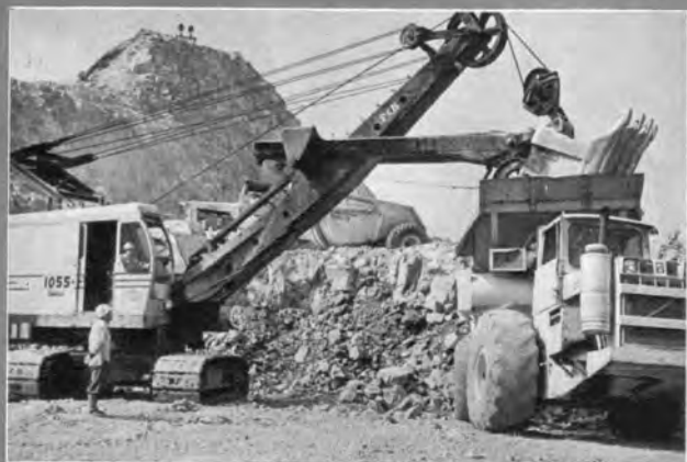
↑牧尾ダム工事：余水吐掘削によるロック材料 の積み込み（昭和34・9）
