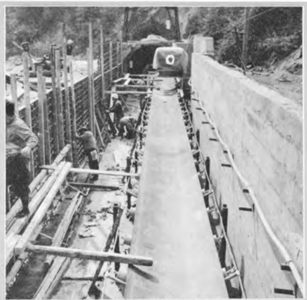
↑ベルトコンベヤのずい道部分 (途中一部地上へ現われた箇所)
