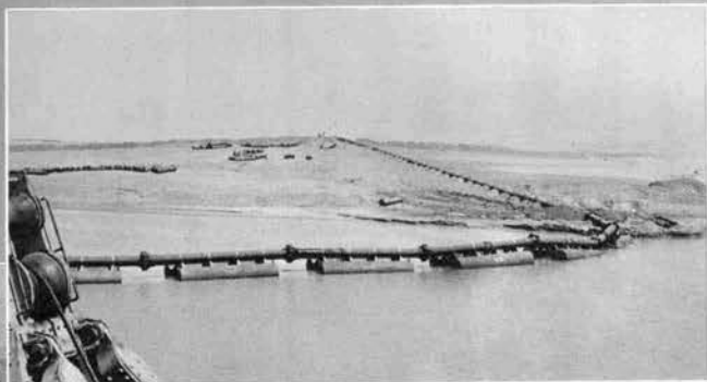
↑砂漠中の配管
