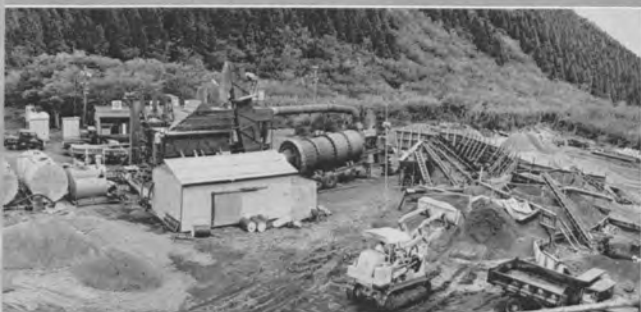
↑アスファルトプラント(バーバーグリーン社製) 能力 60t/h
