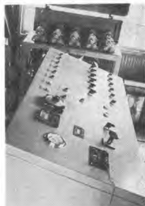
写真-6 NAP-15AZV アスファルト プラント自動操作盤
