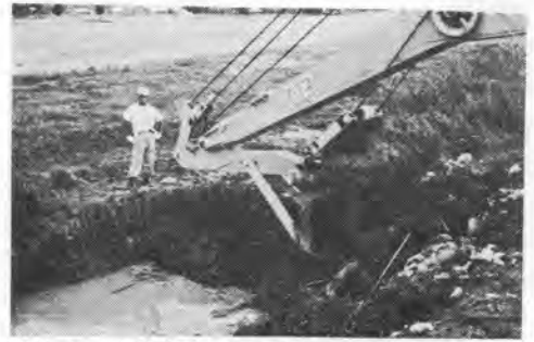
写真-2 湿地帯排水のため 0.6 m 3 バックホーによる排水溝掘削中
