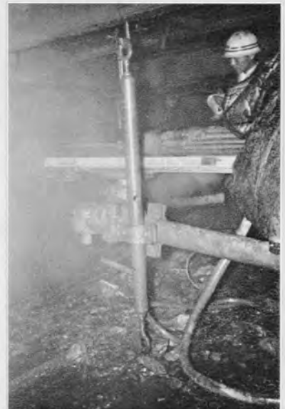
↑パイロットボーリング 地質不良の個所では随時先進ボーリングを行なった。コアは採れないが熟練すれば線粉の色等によってかなり正確に地質を知ることができる。
