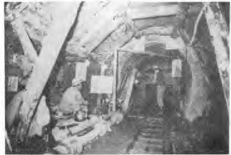
写真-7 空気調整室および気室入口
