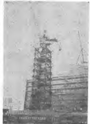
写真-1 10 t 水平引込クレーン
