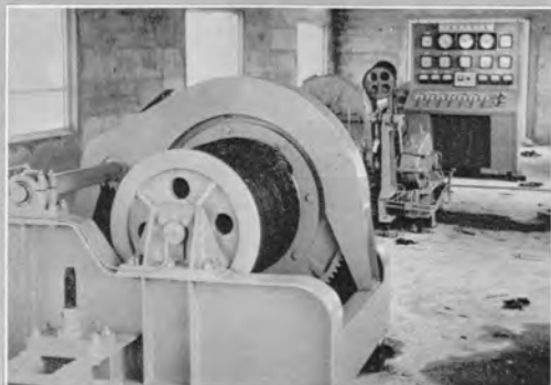
↑開門巻上機 (左岸開門操作盤)
