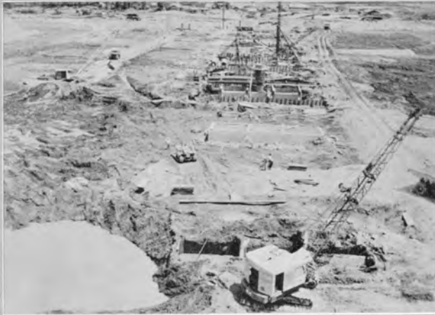
↑沈設完了したケーソン 手前はケーソン周りの掘削作業中 (ドラグライン 0.6m 2 )
