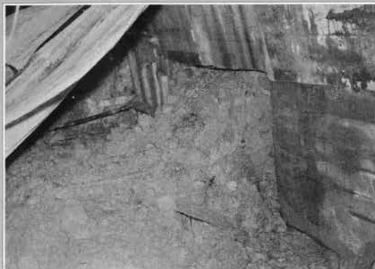
↑ 来宮方坑口から80m 付近の土砂流出状況
