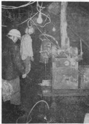
写真-9 薬液注入ボーリング状況 注入を終わりボーリングに移るところ、下方にY管が外されている
