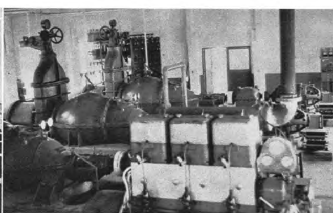
↑第1排水機場のポンプ設備
