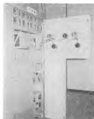
写真-4 自動制御盤
