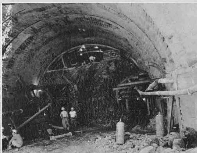
↑ 悪地質に対処して施工した天王山トンネルの 側壁導坑方式 (昭和35年10月)
