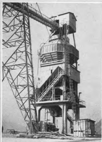
↑右写真のアーチダム工事用 バッチャープラント(112S)
