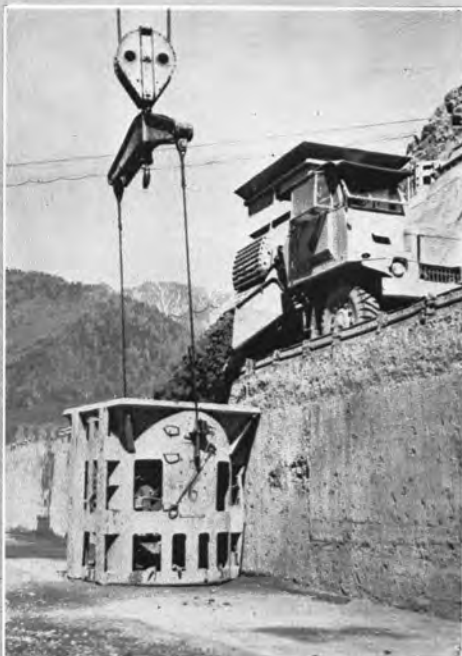
↑提体コンクリート打設用のホッパーカー およびケーブルクレーンバケット(3m 3 )。 この工事においてはレール式のトランス ファーカーの代りにトラック式(日野Z G改造)のものを使用した。この方式は わが国では初めてである。
