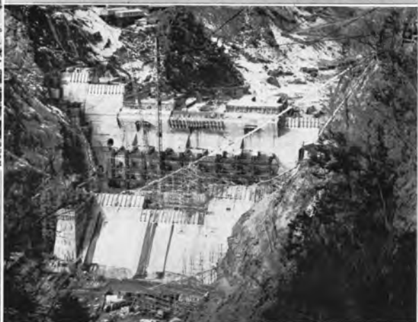
↑昭和36年1月 発電所建家の鉄骨組立が順調に進み、ダム越流路の形も現われてきた。
