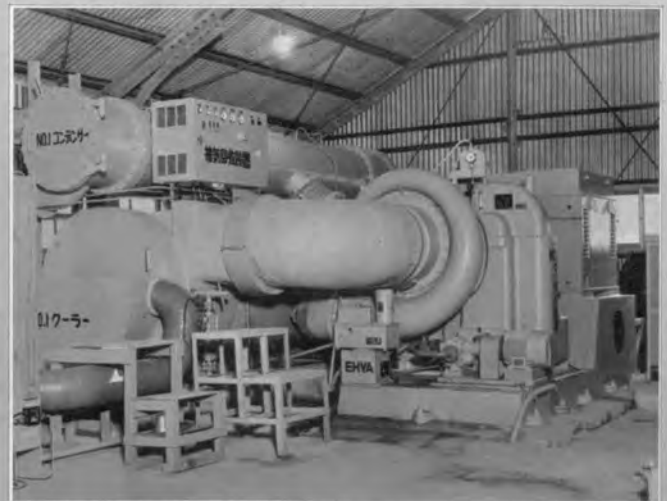
↑ダムクーリングプラントのターボ冷凍機 (300Rt 2台)
