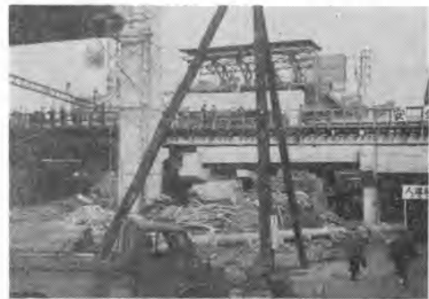
写真-3 放22渋谷駅山手線ガードの建設 上方は高速道路3号線
