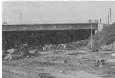
写真-7 (環6)放4との交点の立体交差橋りょう架設状況 (8) 環状6号線(京王線立体改良)
