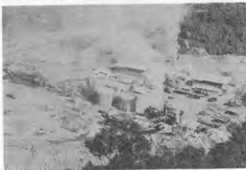
写真-1 アスファルトプラントとクラッシングプラントの全景
