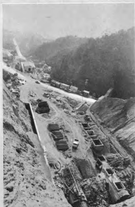
↑ストックパイル(土砂だめそう) 築造中の状況 2列の暗きょが造られている。
