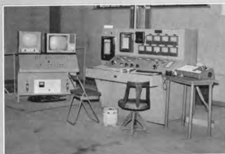
↑統括制御室の内部 右にある制御盤でベルトコンベヤーの運転を行い左のテレビ受像器で要所々々の運転状況を監視する。
