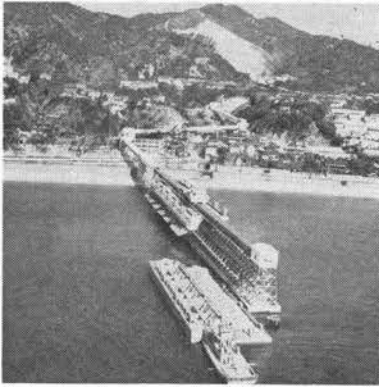
写真—14 埋立土砂運搬用コンベヤ (久保田鉄工製)
