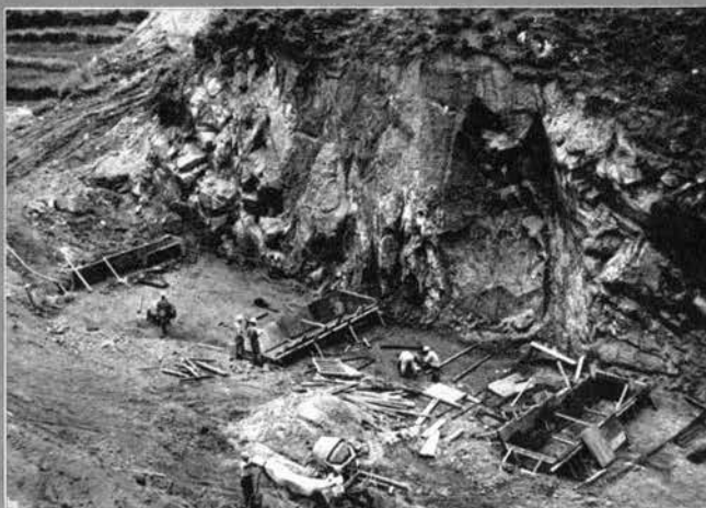
↑ 横断構造物の基礎コンクリート型わくの組立はじまる
