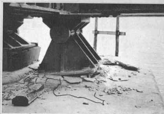
↑ 新松浜橋シュアの被害 固定シュアのアンカーボルトは引抜かれています。可動シュアもかなり移動している。
