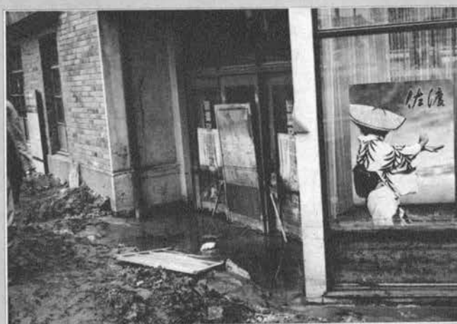
↑新潟交通ビルの沈下（万代橋駅側） 約1mの沈下により1階の床に水が溜っている。
