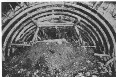
写真-6 鋼製支保工
