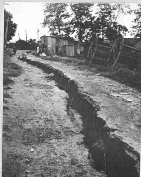
↑ 新松浜町付近の堤防上の亀裂 盛土部分にはすべり破壊のように縦亀裂が多い。
