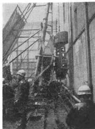
写真-11 隣接ビルとの間げき15~20cm
