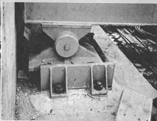
↑ 新松浜橋北側アバットの可動シュアの移動 橋台は河心側へ押し出されている。
