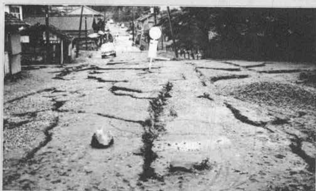
↑ 旧松浜橋取付道路の被害
