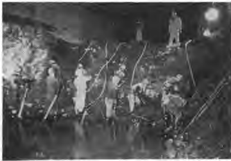
写真-2 レッグドリルによる下部半断面掘削 中央線多治見トンネル複線化工事
