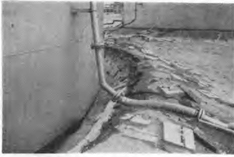
写真-2a ある石油タンクの震害
