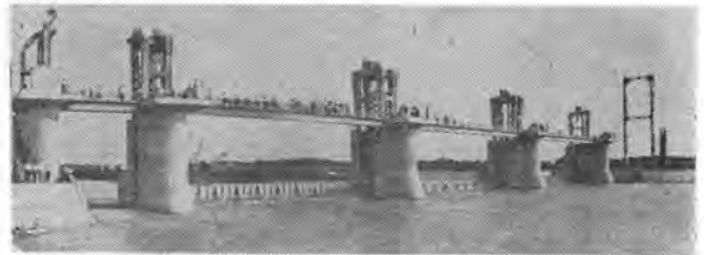
写真-2 たん水した秋ヶ瀬取水堰全景(一部工事中)
