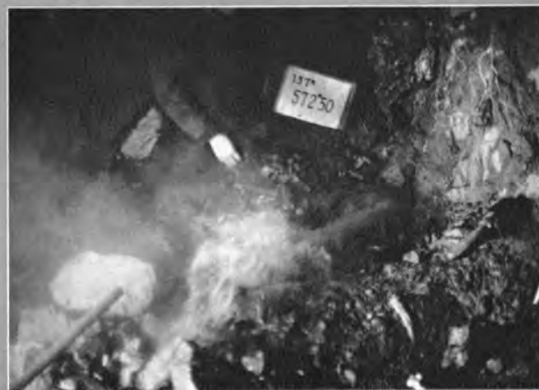
↑第1工区 大宮起点137km572m付近に噴出した温泉
