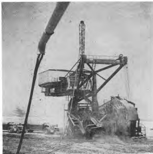
写真-1 San Luis ダム工事における大型ホイールエキスカベータ(Bucyrus社製)、建設用に用いられている最大の機械で電気駆動形式、バケットの背面がチェーンマットになっている。
