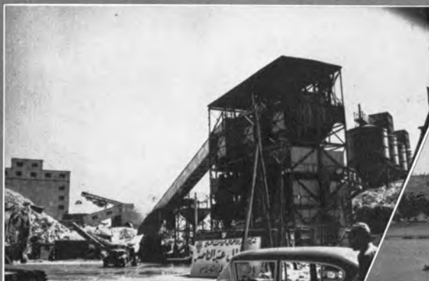
↑ バッチャープラント
