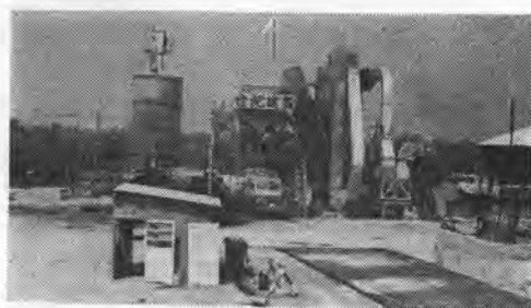
セダラピッドH-20、全自動バッチプラント60~80t/時2基が彦根地区にて稼働中
