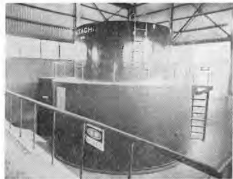
写真-3 仮設ポンプ場における6,200 kW電動機
