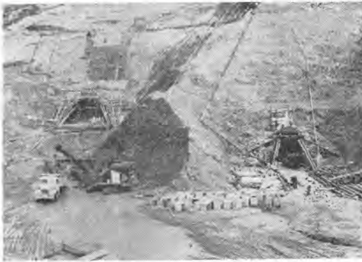
写真-6 仮排水路トンネル下口坑口付近 (油谷24Bパワーショベルと6tダンプトラック)
